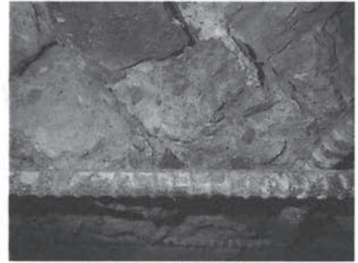
写真-12 破碎状況 (下面空洞より)
