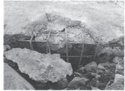
写真-9 破碎状況
