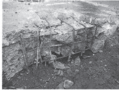
写真-11 破碎状況 (側面土砂撤去後)
