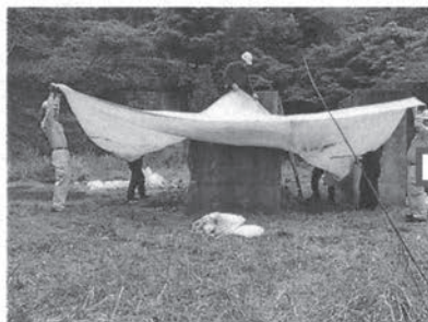
写真-22 (1重目) 防爆シート
