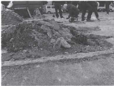
写真-10 破碎状況
