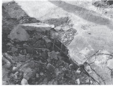
写真-8 破碎状況
