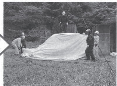
写真-24 (3重目) 防爆シート
